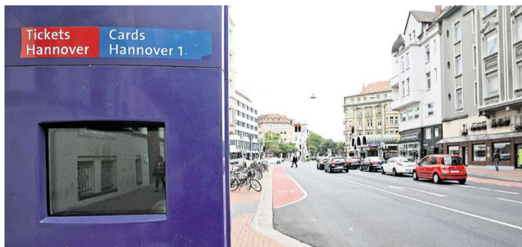
Der Monitor bleibt vorerst schwarz: Bei den Bauarbeiten am Lister Platz wurde die Stromzufuhr für das Info-System der Üstra durchtrennt. FOTO: OBERDORFER
